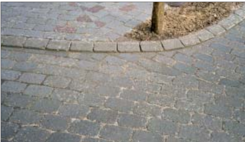
Figur 4.16. I denne belægning har der været gravet op for at reparere telekabler.
