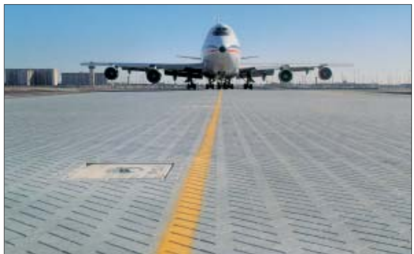
Figur 2.6. Betonsten er meget velegnet til at optage store hjultryk fra eksempelvis fly. Fly kan have hjultryk på op til ca. 40 ton.
