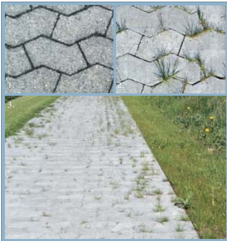
Figur 4.13. (1) Gamle fyldte fuger er meget modstandsdygtige over for ukrudt, hvorimod ikke-fyldte fuger (2) giver gode vækstbetingelser for ukrudtet. (3) Endvidere er det vigtigt at lave en ordenlig kantafgrænsning, således at eksempelvis græssets rodnet ikke vokser ind i befæstelsen. Hovedproblemet her er dog ikke-fyldte fuger.
