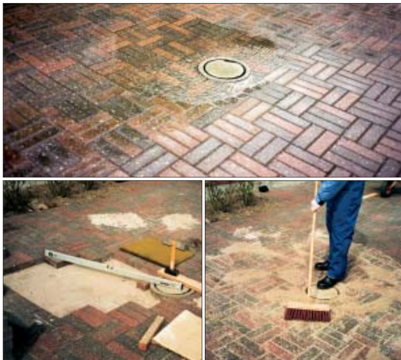
Figur 4.18. Ved brønddæksler og lignende opstår der ofte lunger pga. for dårlig komprimering, eller manglende overhøjde ved lægningen. Oprettningen udføres dog let.
