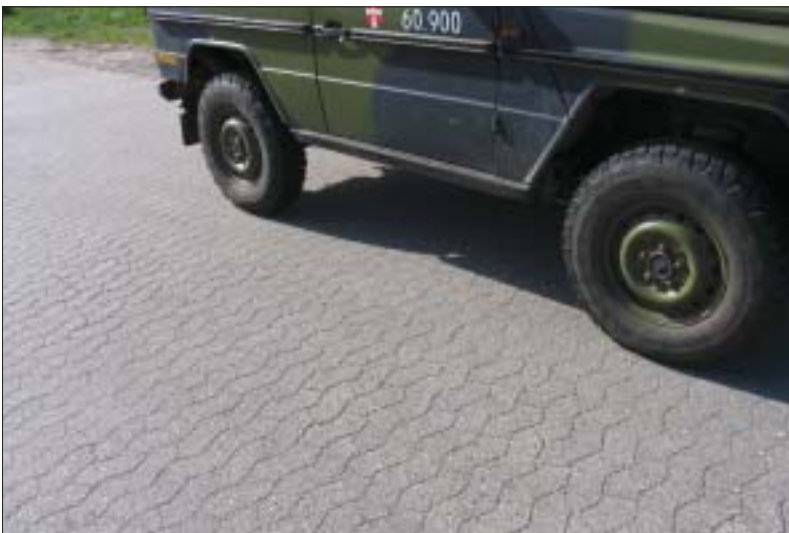
Figur 2.39. Militarareal med ca. 15 år gamle betonsten, der dagligt har været udsat for kørsel med bæltekøretøjer. Stenene er kun slidt meget begrænset.
