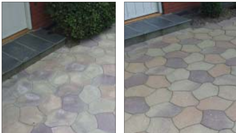
Figur 4.8. Til venstre ses almindelige kalkutfældninger på farvede sten. Billedet til højre viser samme belægning 2 år senere. Det ses, at kalkutfældningerne er væk, hvilket skyldes almindeligt slid samt vind og vejr generelt.
